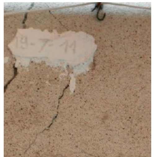
fissure et témoins en plâtres
