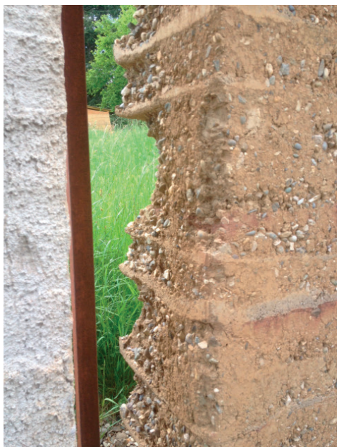
Erosion de l'angle
