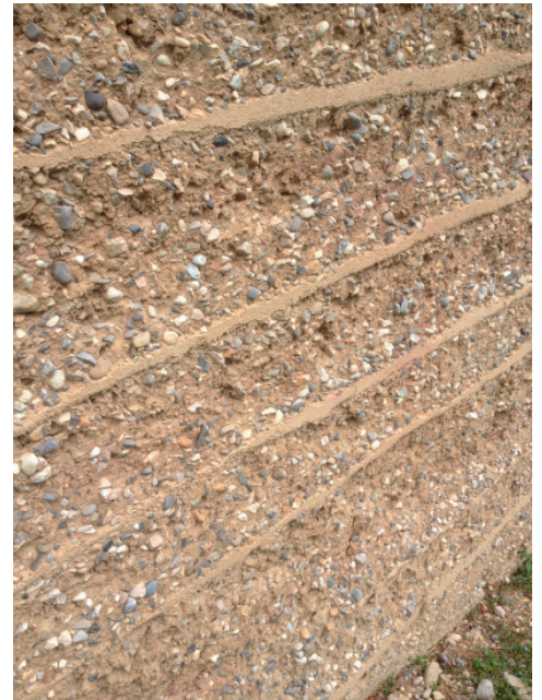
Erosion du mur
